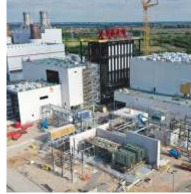
UK KEADBY 2 Enerji İstasyonu EPC Siemens Enerji
